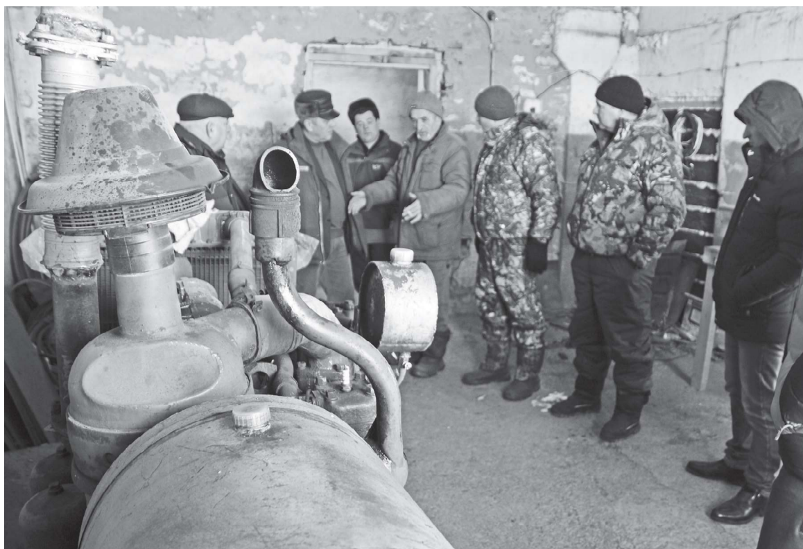
Вот такой движок от гусеничного ДТ-75, с лета прошлого года ставший автономной электроподстанцией, стоит в коровнике животноводческой фермы в д.Когунек (КФХ «Филиппова Н.В.»). В случае отключения электричества он обеспечивает энергией весь животноводческий комплекс КФХ, а не только коровник
