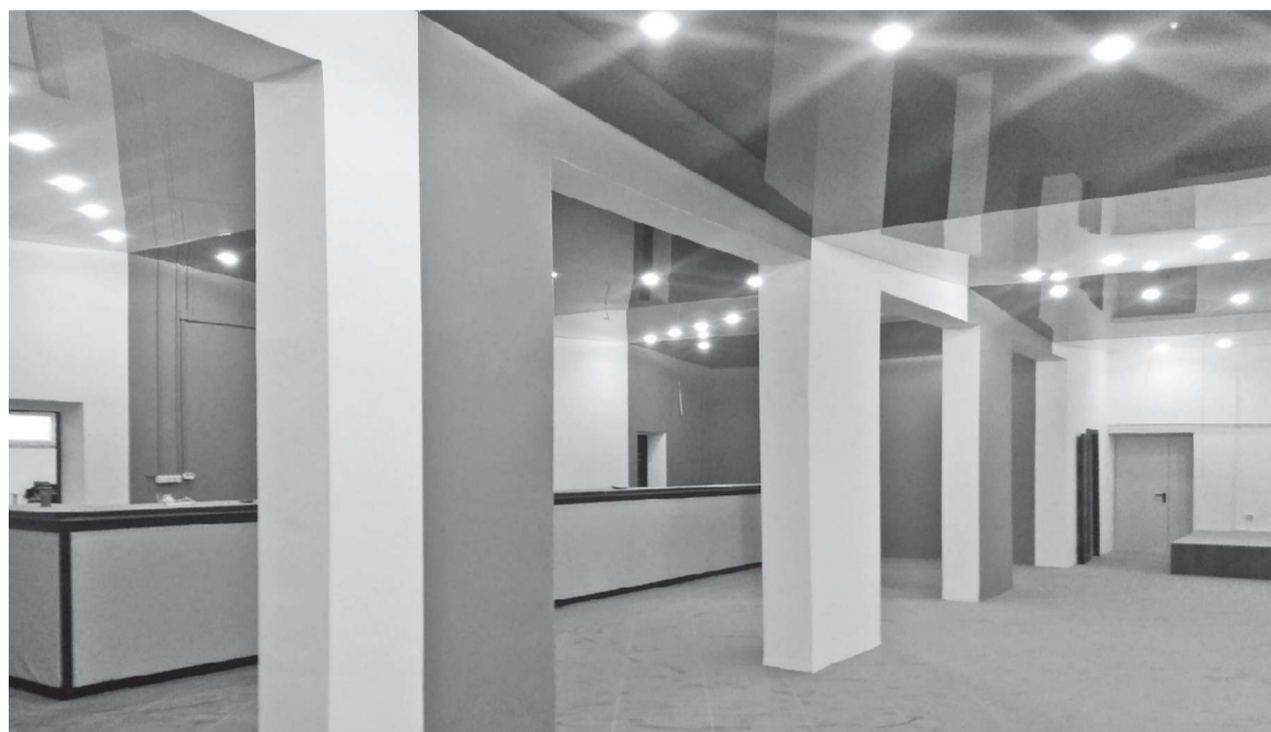
На втором этаже, где когда-то была прачечная, а затем долгие 30 лет – вообще ничего, кроме битого кирпича и мусора, разместится современное кафе. Помещение практически готово к заселению: как говорится, осталось пыль протереть да мебель расставить
