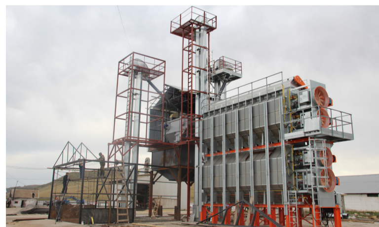
На зернотоке в д.Монастырёво поставили мощнейший новый сушильный комплекс, производительностью 1200 тонн зерна в сутки, в то время как действующая сушилка 2016 года установки способна прогнать лишь 100 тонн в сутки.
